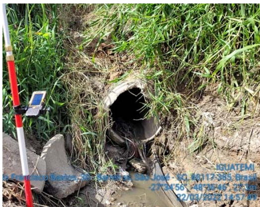
Figura 11 – Bueiro Existente - Necessário Limpeza e Construção de Ala
