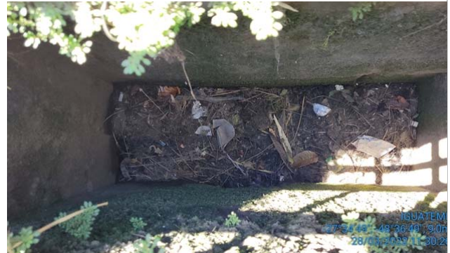
Figura 8 – Caixa Existente – Necessário Limpeza e Desobstrução
