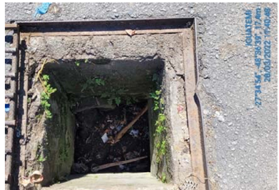
Figura 4 – Caixa Existente – Necessário Limpeza e Desobstrução
