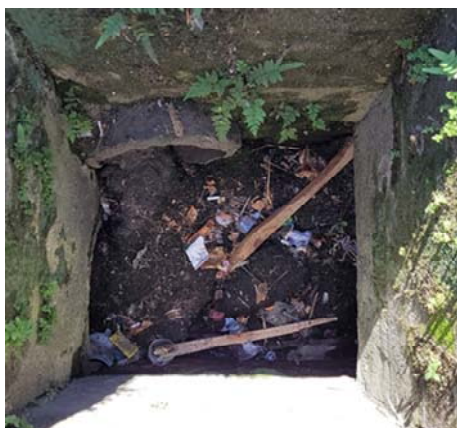
Figura 5 – Caixa Existente – Necessário Limpeza e Desobstrução
