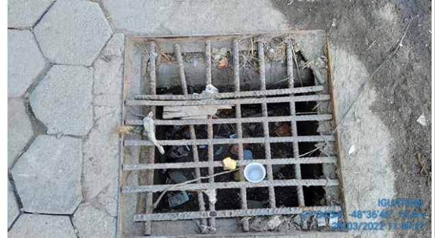
Figura 2 – Caixa Existente – Necessário limpeza e substituir grelha de ferro
