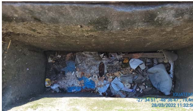
Figura 7 – Caixa Existente – Necessário Limpeza e Desobstrução
