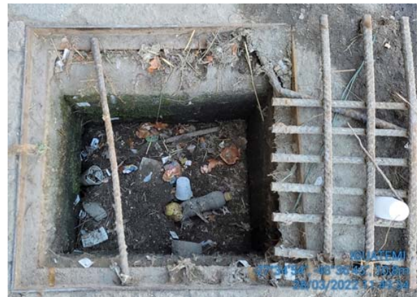
Figura 6 – Caixa Existente – Necessário Limpeza, Desobstrução e Substituir grelha
