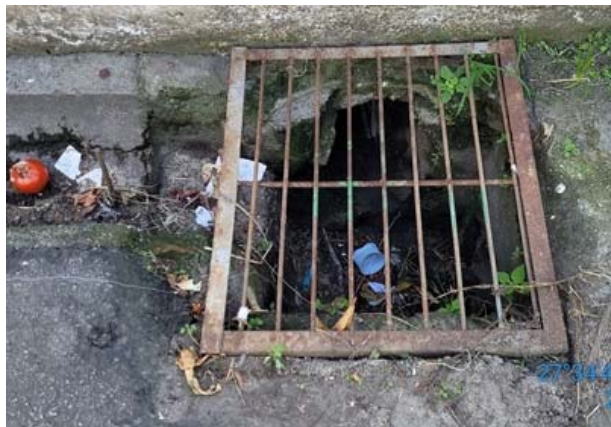
Figura 9 – Caixa Existente – Necessário Limpeza
