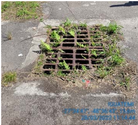
Figura 1 – Caixa Existente – Necessário Limpeza
