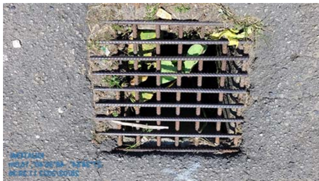
Figura 3 – Caixa Existente – Necessário Limpeza
