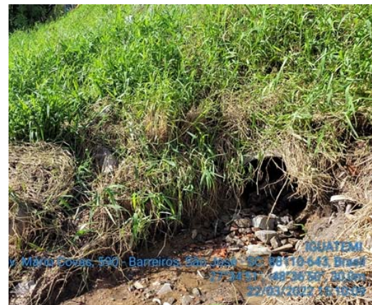
Figura 12 – Bueiro Existente - Necessário Limpeza e Construção de Ala
