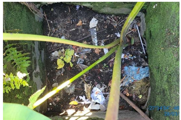
Figura 10 – Caixa Existente - Necessário Limpeza e Desobstrução
